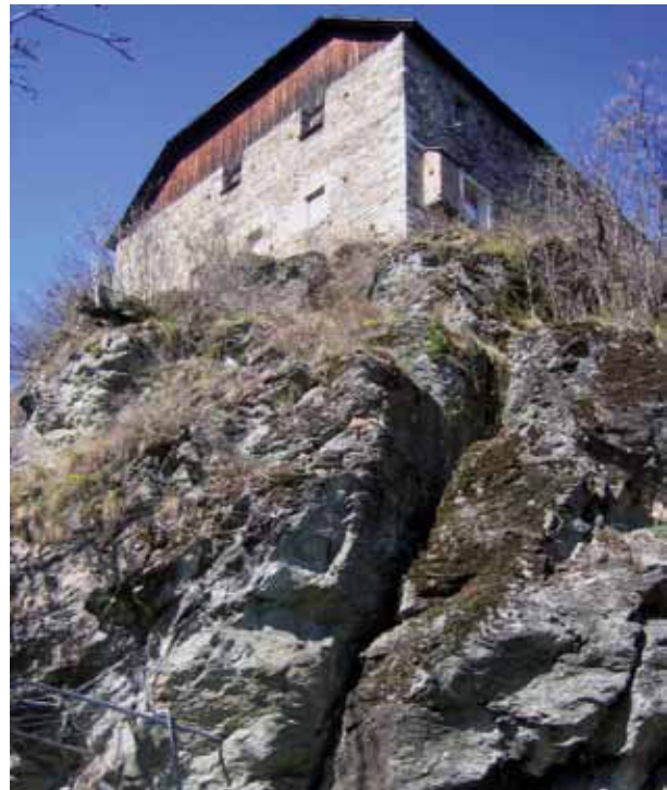
Abb. 2: Schloss Summersberg steht auf Amphibolit; das Gestein ist völlig zerklüftet und besitzt eine hellgrüne Farbe.
